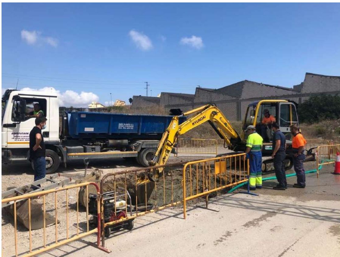
Emalgesa, durante una reparación anterior.
